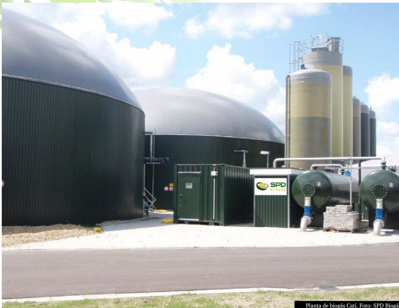
Planta de biogás Catí. Foto: SPD Biogás
