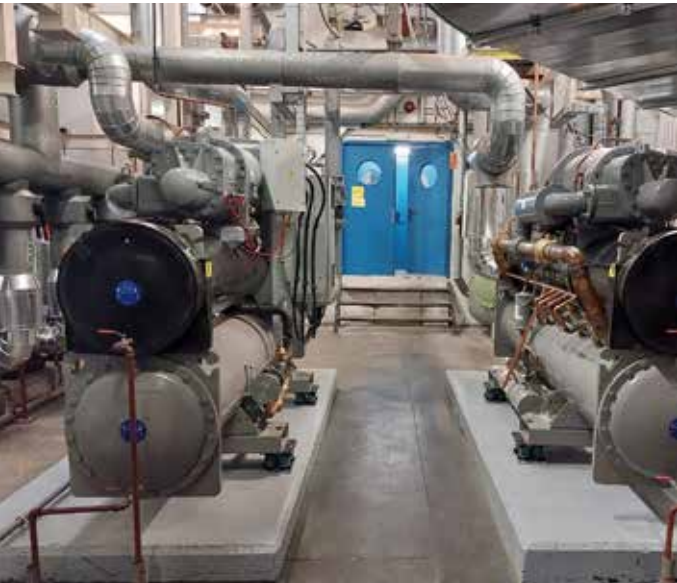
Enfridoras de agua en planta -5.
