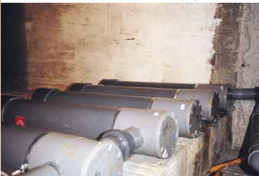
Depósitos-depuradora para la recogida, tratamiento y distribución de aguas grises a las cisternas.
