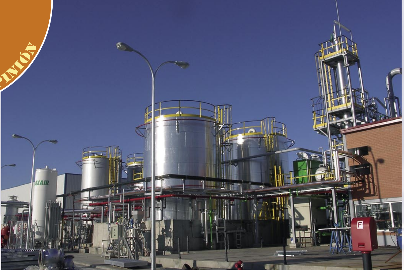
Planta de biogás. Foto: IDAE.
