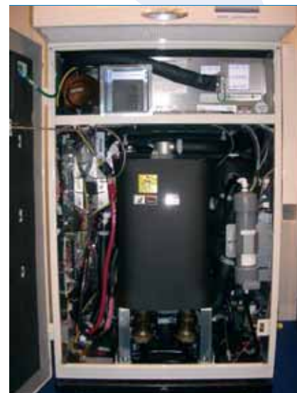
Pila de Combustible modelo GenCore de ARIEMA - Plug Power de 5kW, más barata que un sistema fotovoltaico.
