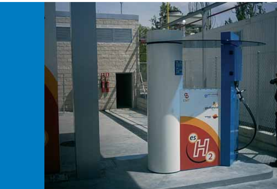
Estación de Servicio de Hidrógeno de Madrid, que ha suministrado a cuatro autobuses.
