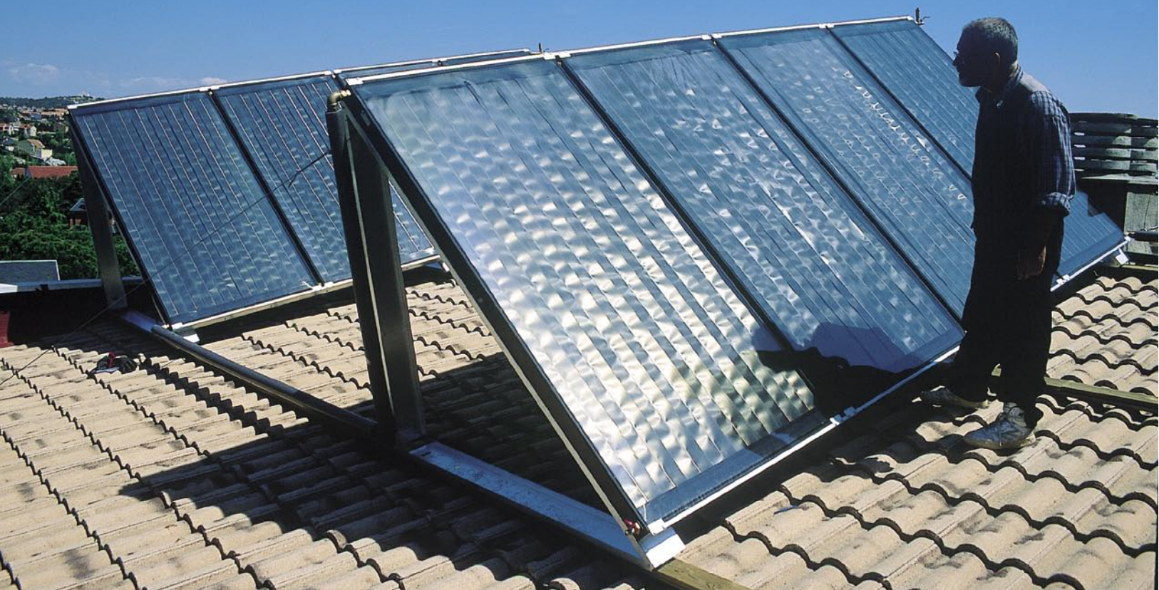
Energía solar térmica.
