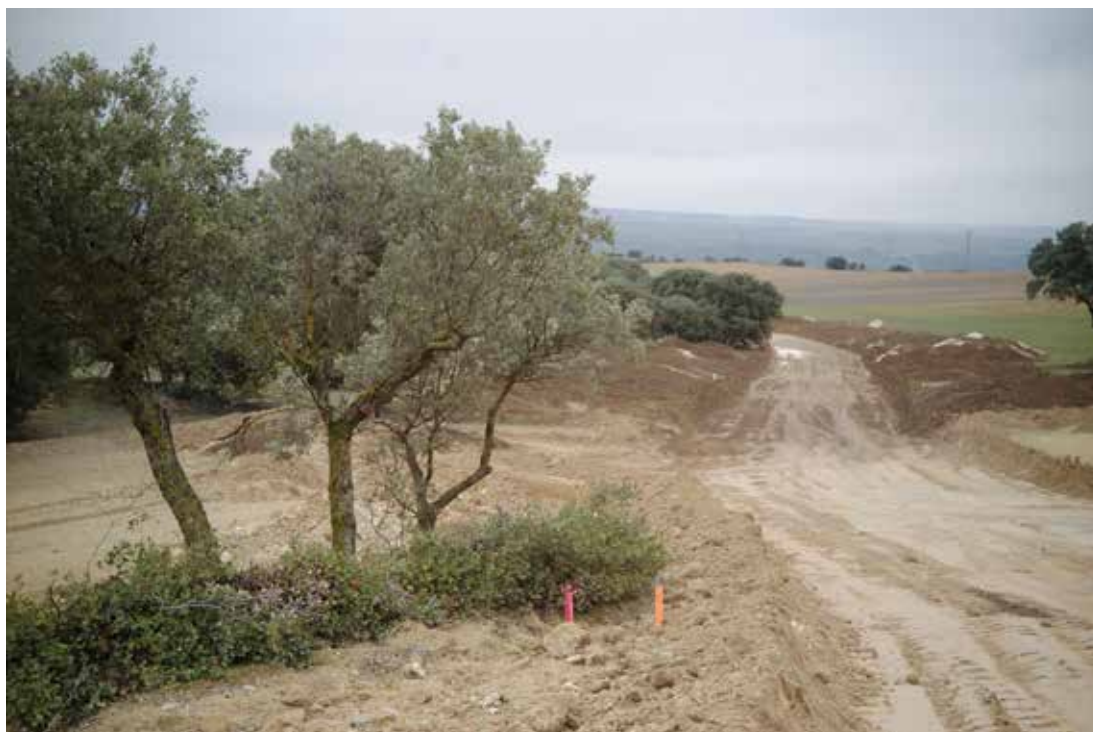
Marcado de elementos vegetales para que no sean afectados durante las obras.
