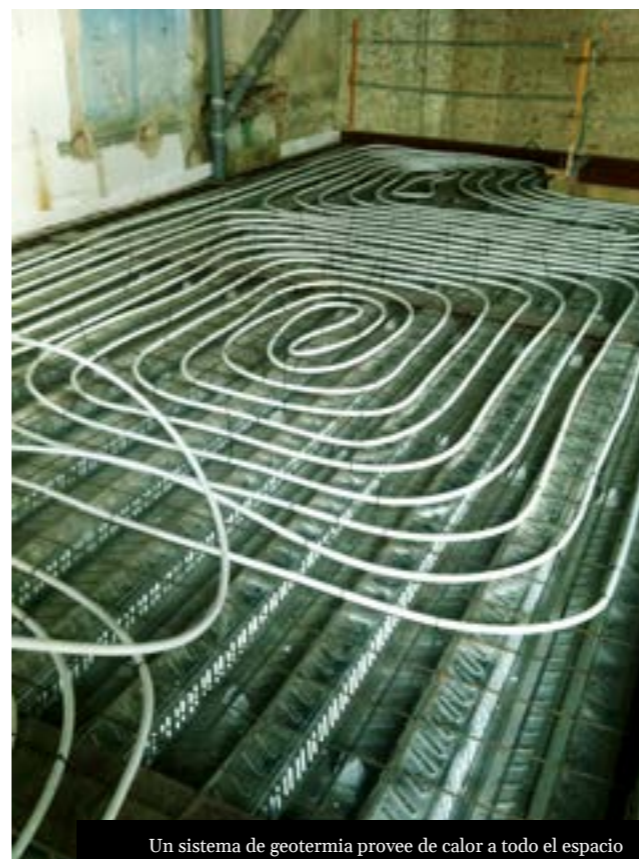
Un sistema de geotermia provee de calor a todo el espacio
