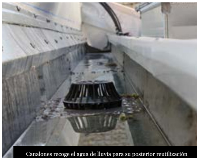
Canalones recoge el agua de lluvia para su posterior reutilización
