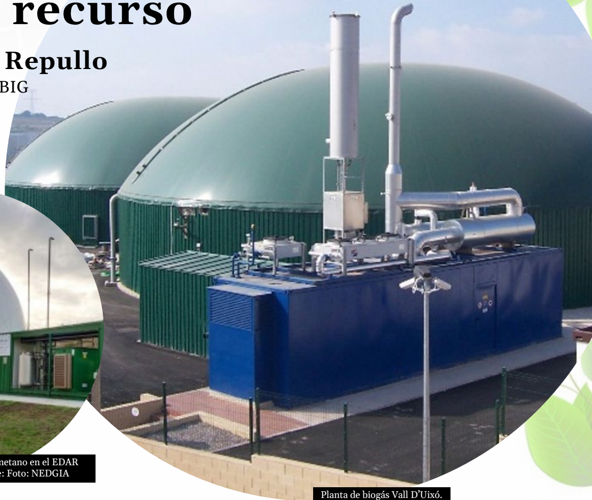
Planta de biogás Vall D'Uixó. Foto: BIOVIC
