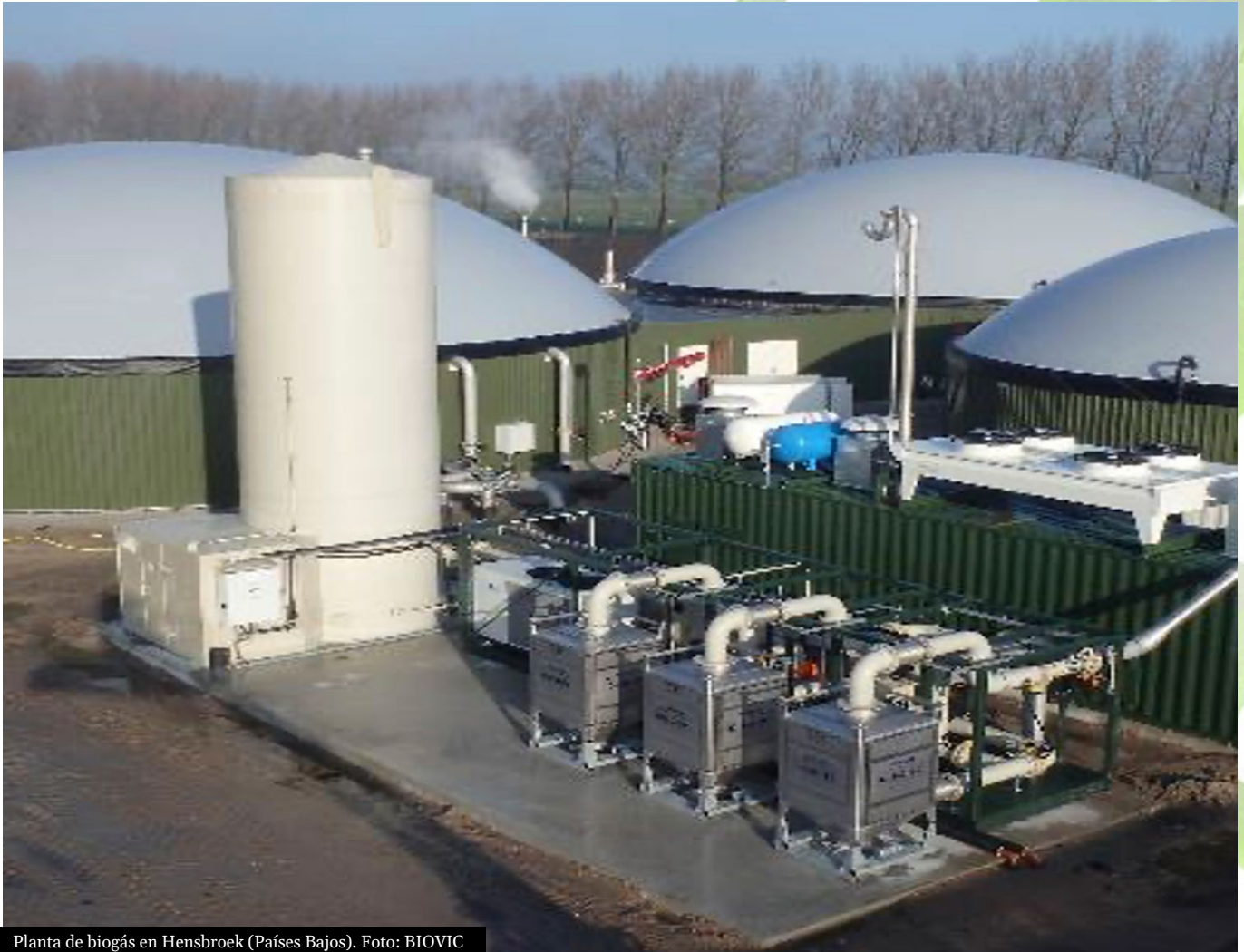
Planta de biogás en Hensbroek (Países Bajos). Foto: BIOVIC
