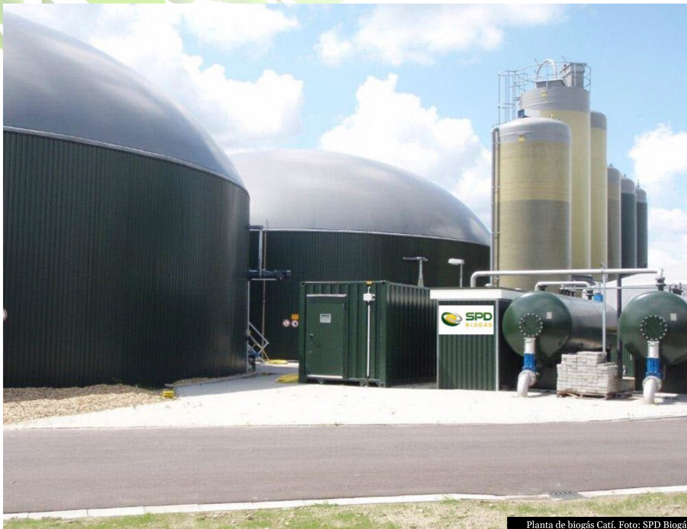
Planta de biogás Catí. Foto: SPD Biogás
