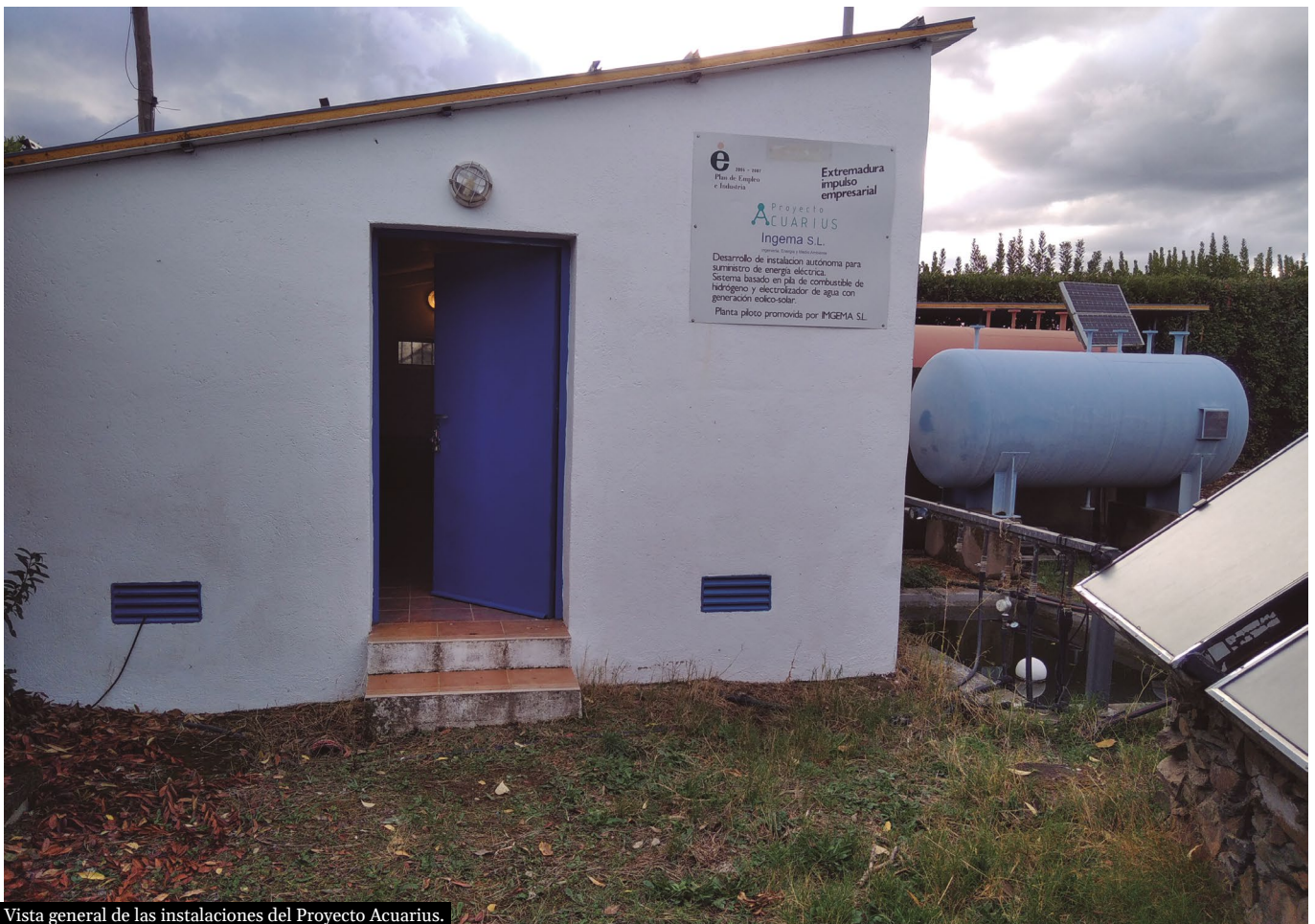
Vista general de las instalaciones del Proyecto Acuarium.
